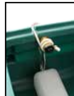
Frostschutz-Heizleitung am Ventil
